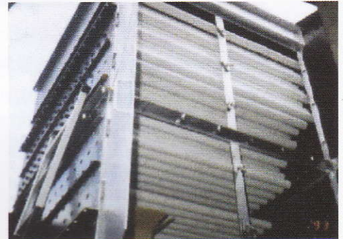
セラマジック・脱臭塔充填・約5000本
