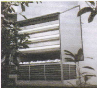
セラマジック+UFO・屋外壁面設置
