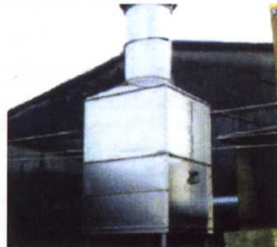
セラマジック・屋外脱臭塔
