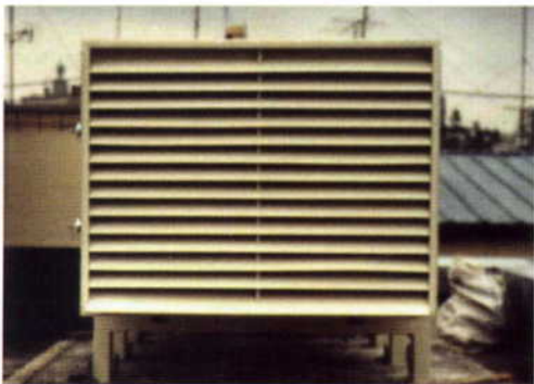
セラマジック+UFO・屋上設置
