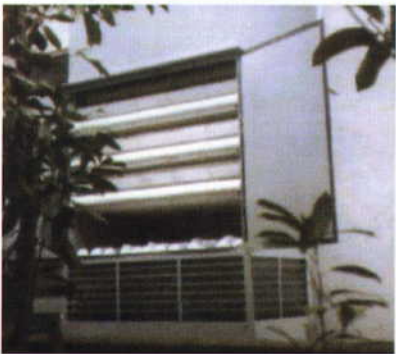
セラマジック+UFO・屋外壁面設置
